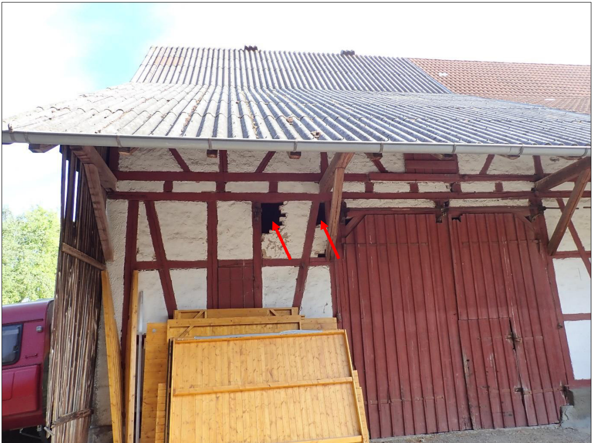
Abbildung 7: Schadstellen im Fachwerk der Scheune (rote Pfeile) nördlich des Wohnhauses Haller Straße 39, die von Fledermäusen und Vögeln als Einflugöffnungen in die Scheune genutzt werden können.
