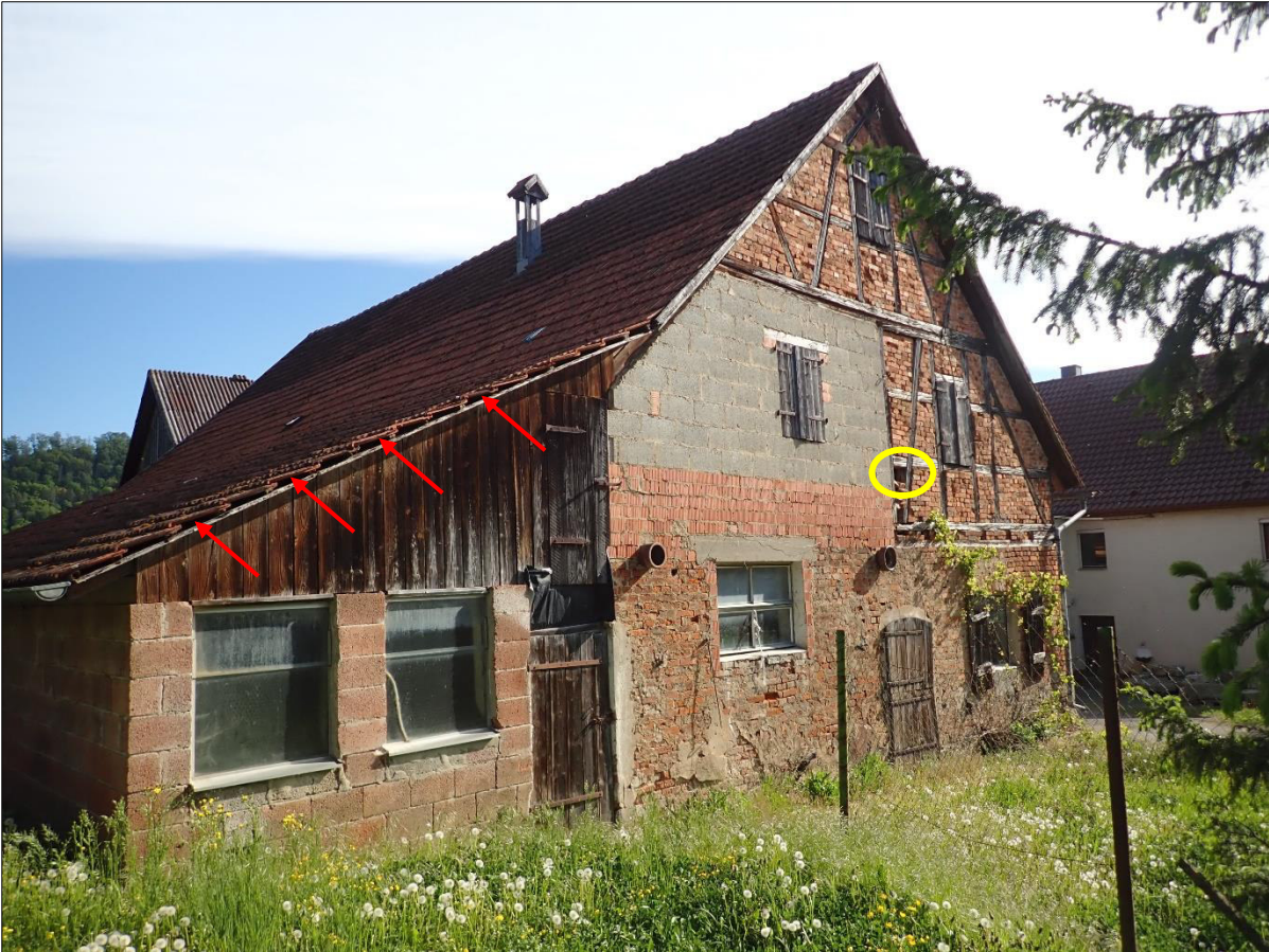
Abbildung 8: Scheune westlich des Wohnhauses Haller Straße 39 mit potenziellen Fledermausquartieren unterhalb von Dachziegeln (rote Pfeile) sowie Einflugöffnungen für Fledermäuse und Vögel in den Innenraum der Scheune (gelbe Ellipse).
