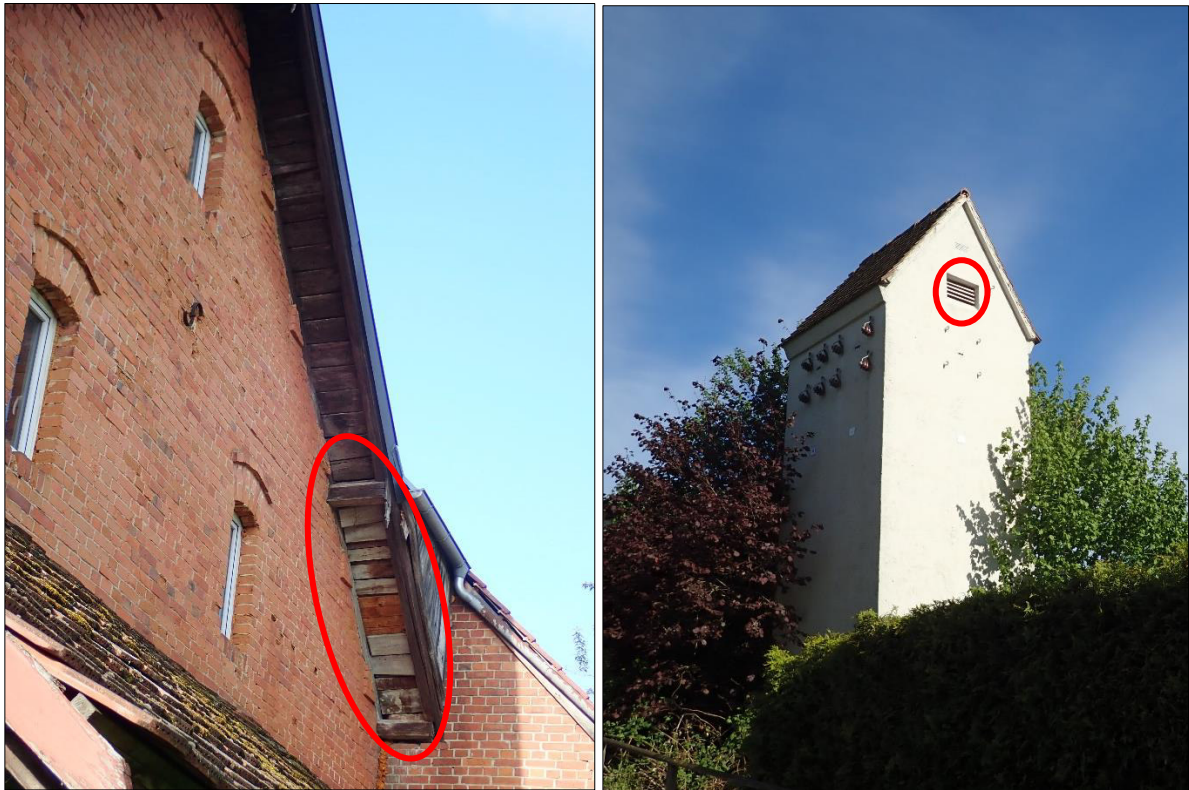
Abbildung 10: Schadstellen und Lücken unterhalb des Traufbereichs des Wohnhauses in der Haller Straße 33 mit Potenzial für Fledermäuse sowie Gebäude- und Nischenbrüter (linkes Bild, rote Ellipse) und Trafohaus mit Lüftungsschlitzen am südlichen Rand des Untersuchungsgebiets, die von Fledermäusen als Einflugöffnungen in den Innenraum genutzt werden können (rechtes Bild, rote Ellipse).
